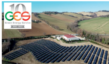
Impianto a terra da 1MW
